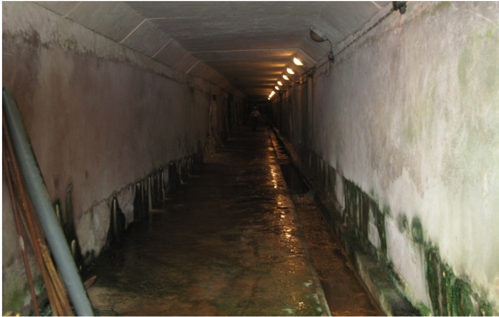
Рисунок 5.3 - Фильтрации воды в потернах бетонной плотины
