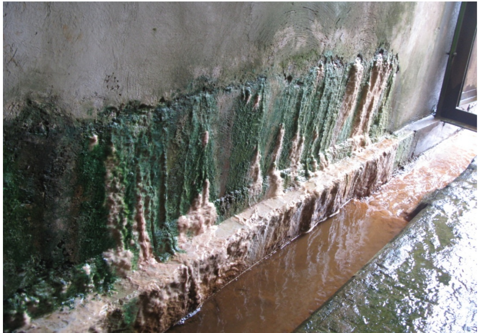
Рисунок 5.4 - Фильтрация воды через горизонтальные швы бетонирования в потерне бетонной плотины
